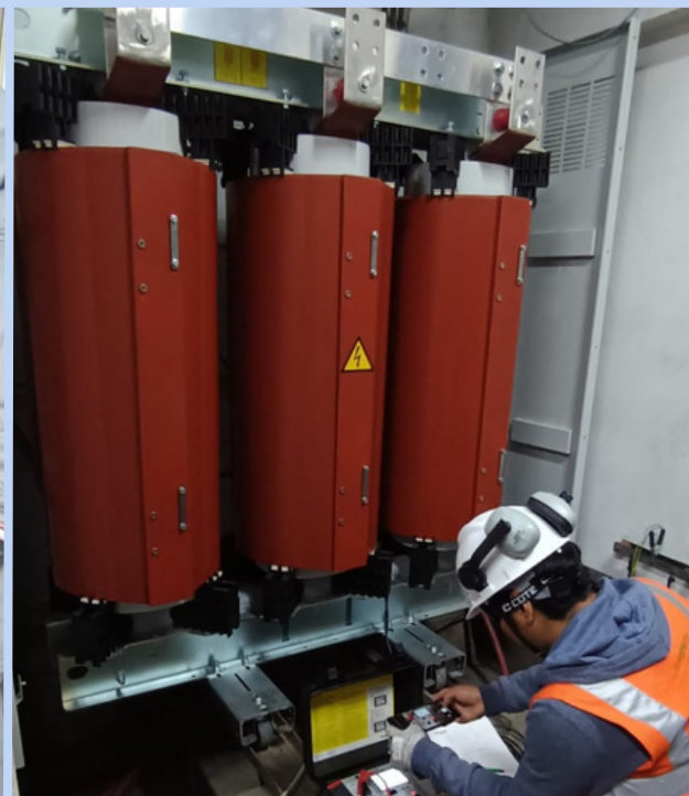
Pruebas eléctricas en transformadores en resina
