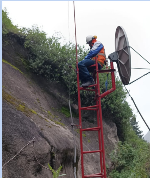
Instalación de protección contra descargas atmosféricas
