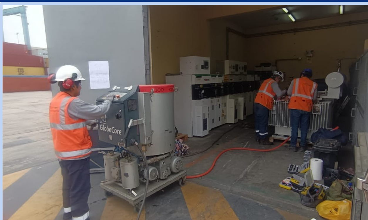
Tratamiento de aceite dieléctrico con maquina de termovacio
