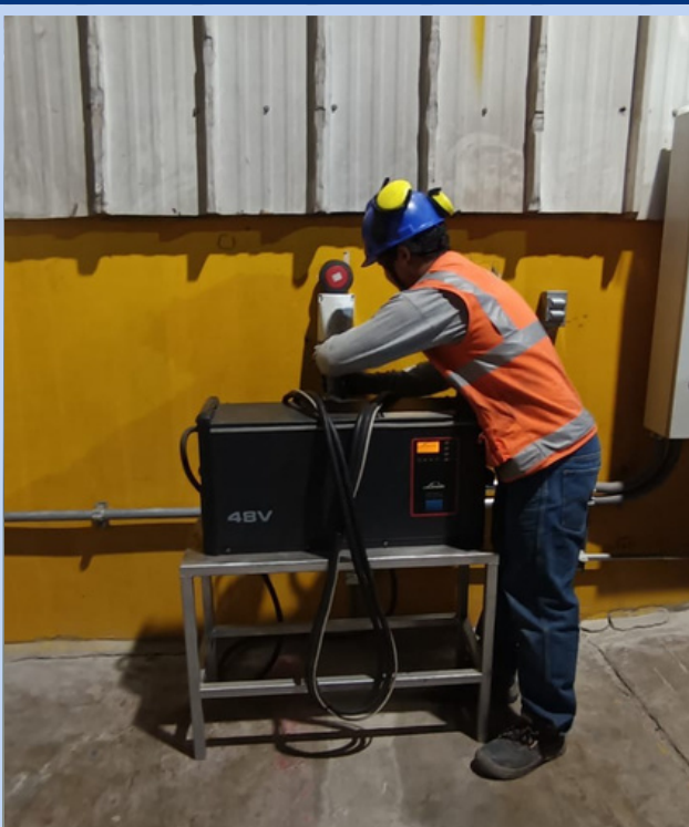
Instalación de cargador de baterías para montacargas
