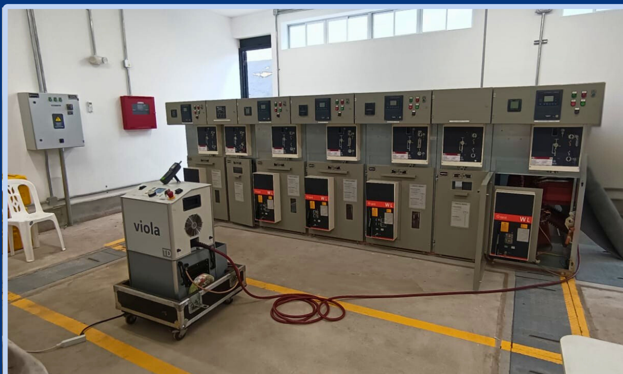
Pruebas eléctricas HIPOT (VLF) a cables de media tensión
