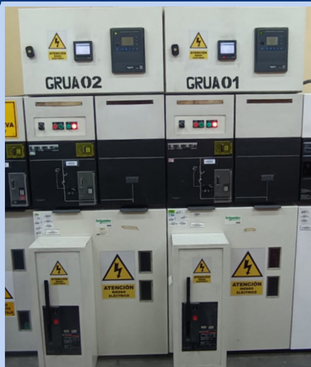
Mantenimiento de celdas de media tensión Schneider
