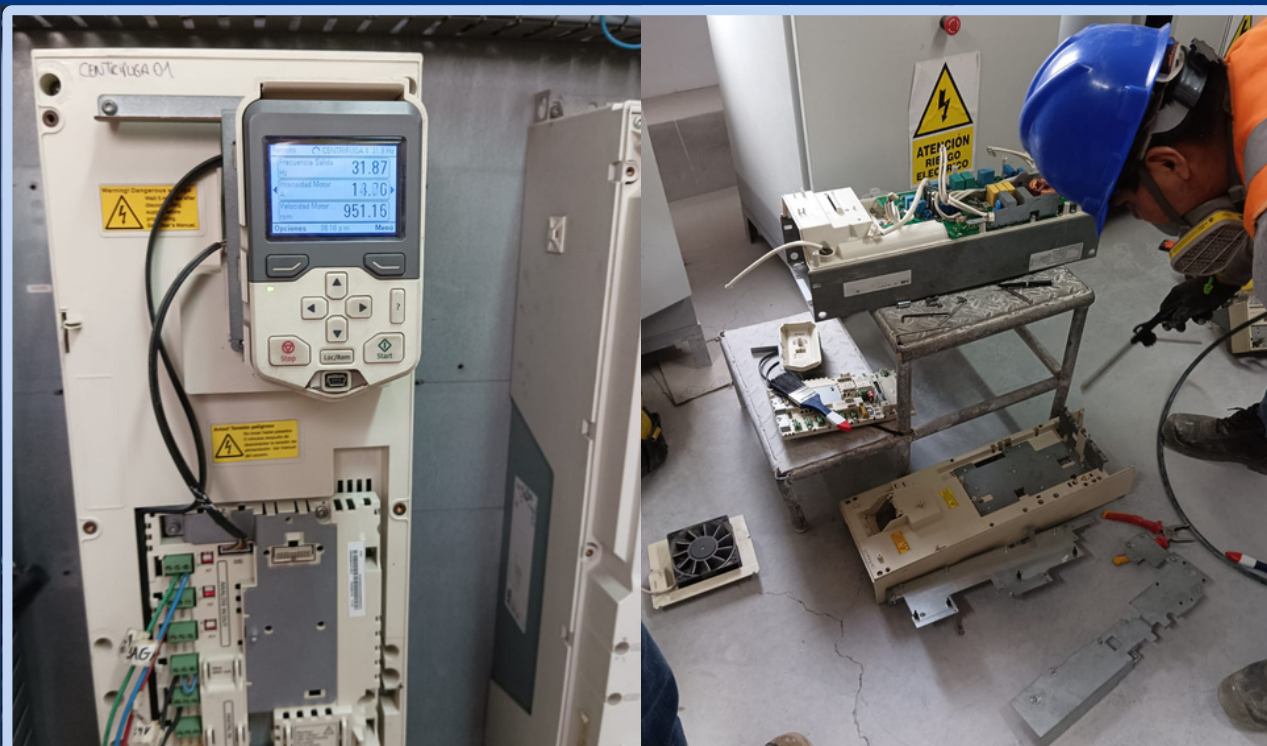
Mantenimiento de variadores de frecuencia para motores
