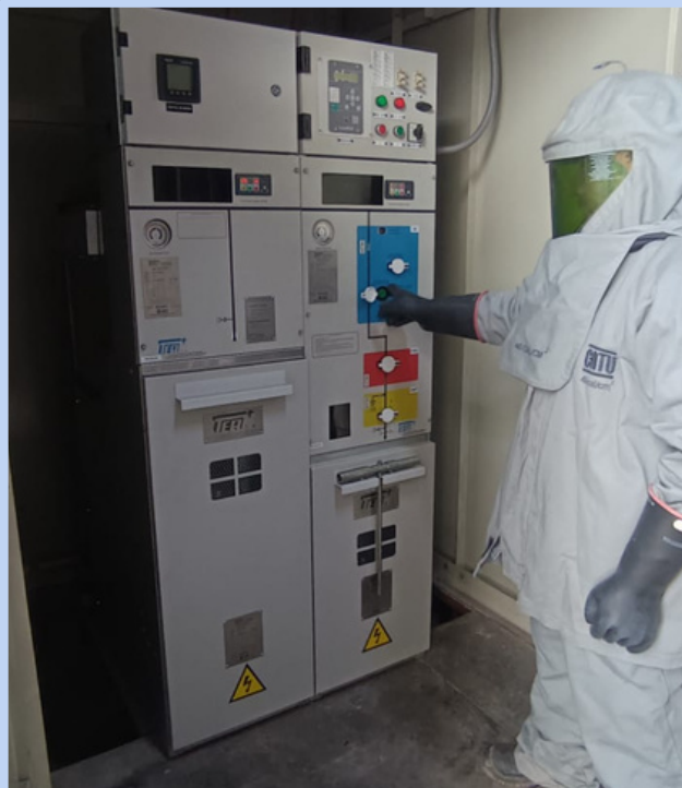
Mantenimiento de Celdas
